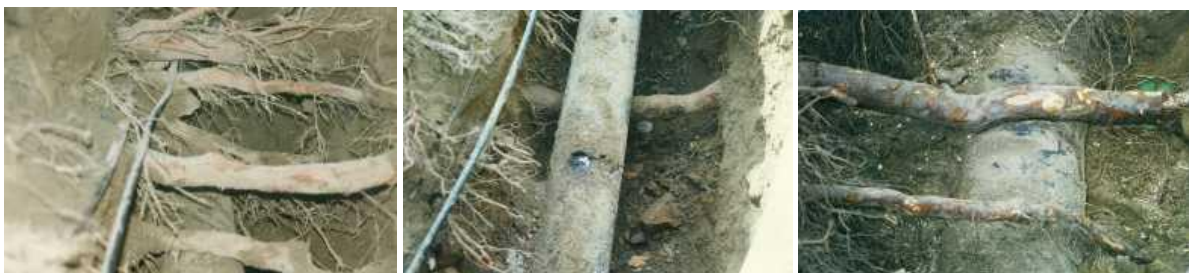
Bild 1: Baumwurzeln im Bereich von Gas-/Wasserversorgungsleitungen (Quelle: https://Baumwurzeln.de )
